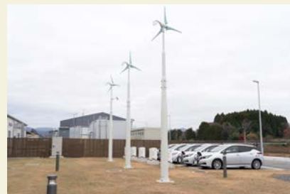
▲EVの充放電システムを活用したエネルギーマネジメントシステムの実用化検証（福島県浪江町）
